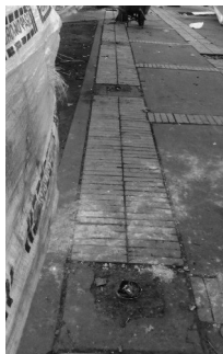
Dados de los tubos de acero que sos- tenían la antigua reja.
